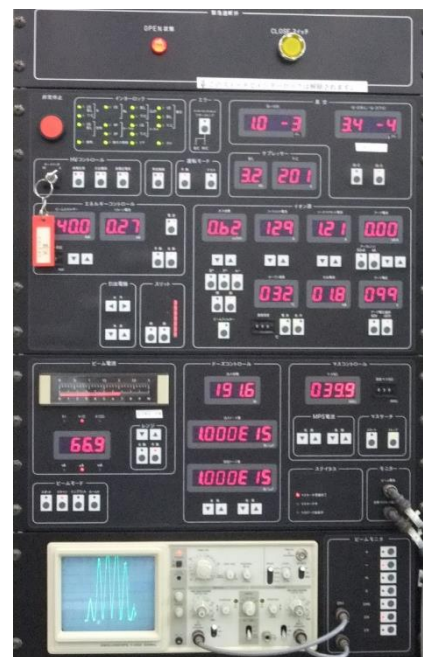
図2. テスト運転時の操作盤の全景。 右端の中央がアークの値。000を指しているのがアーク電流（異常）。 099を指しているのがアーク電圧（正常）。
