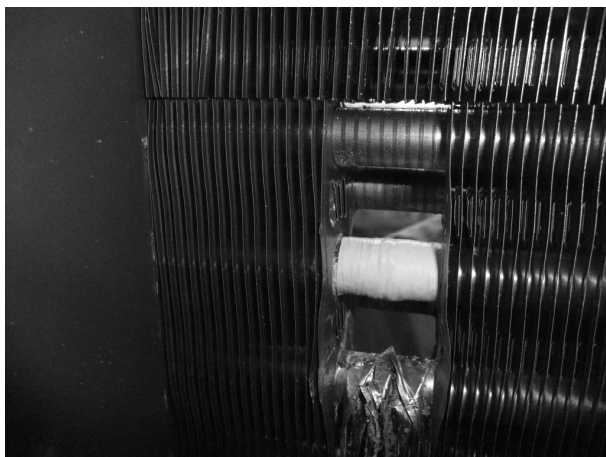
写真 2 配管のテフロンテープ止め
